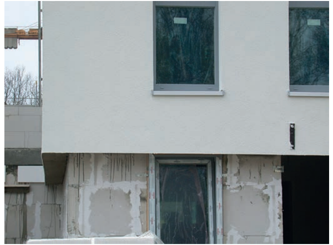
Bild 7. Die große Dämmdicke und die dünne Putzschicht sind maßgebend dafür, dass sich die Putzoberfläche stark abkühlt und unter die Lufttaupunkttemperatur fällt Fig. 7. This high insulation thickness and the thin plaster layer are decisive for the plaster surface cooling intensively down under the air dew point
