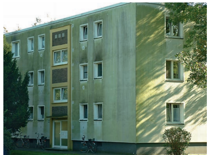
Bild 4. Algenbefall auf der Fassade einer mit WDVS sanierten Außenwand ca. drei Jahre nach Fertigstellung
